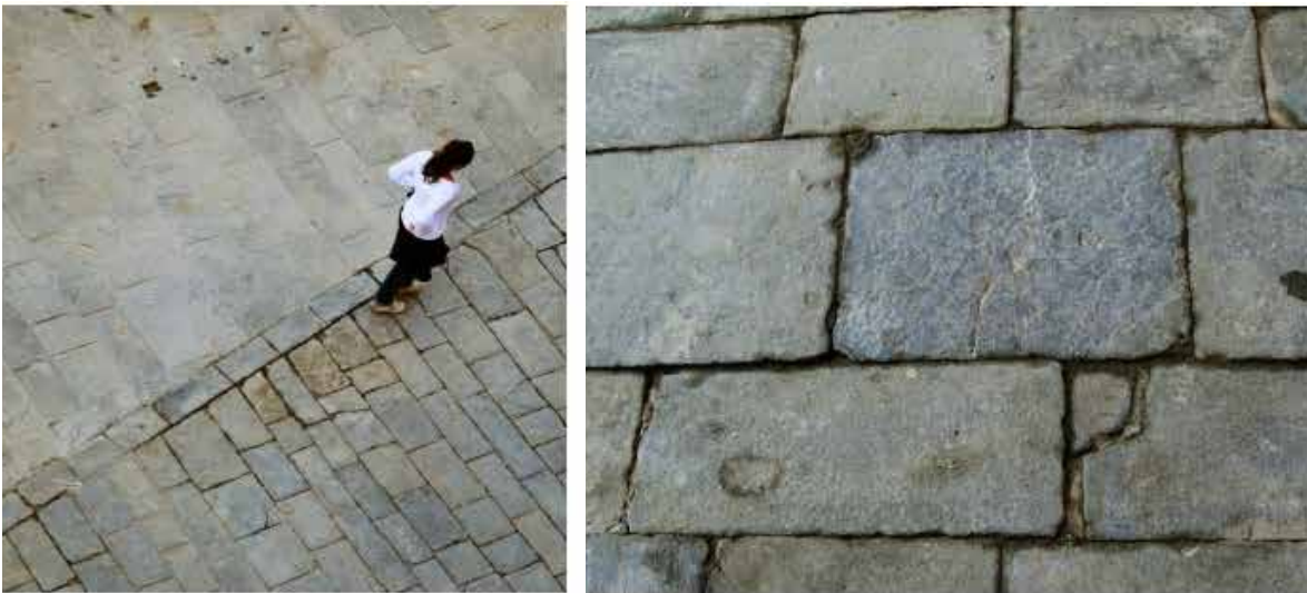
Figura 27. Stato delle pavimentazioni prima dell'intervento
