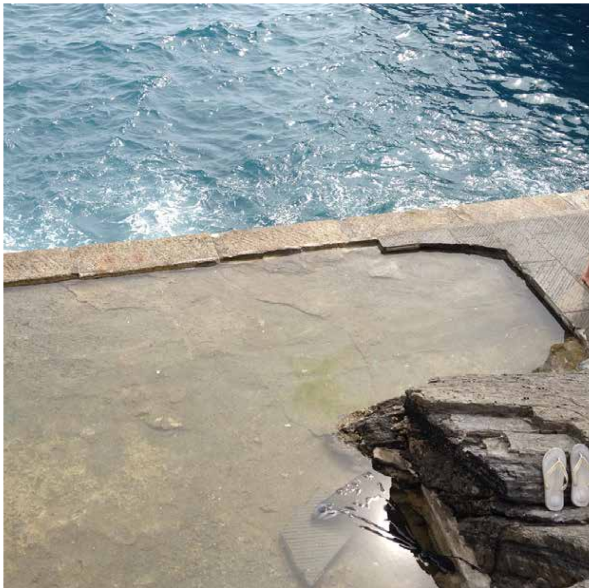
Figura 18. La pavimentazione di Ventegà dopo l'alluvione
